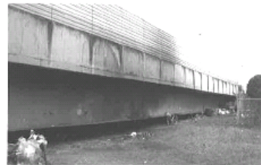
写真-1 被災状況
