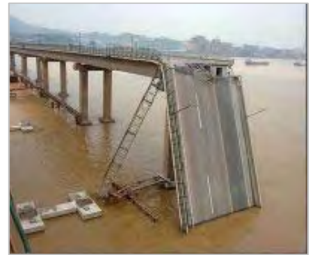
写真-3 九江大橋落橋状況
