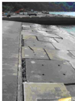
写真-2 台風で被災した張りブリック事例
