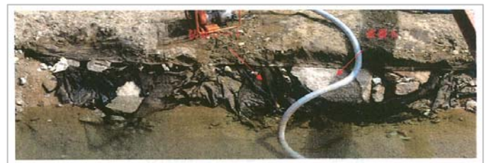
写真-2 試掘状況（防砂シートの破損）
