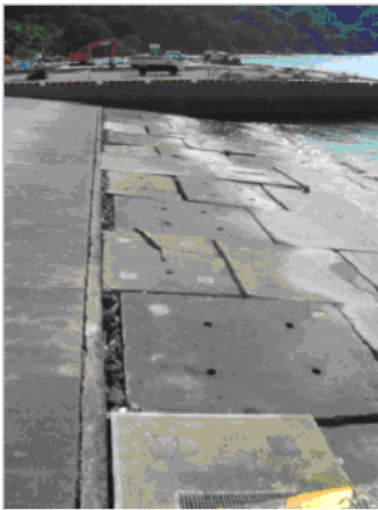
写真-2 被災したブロック
