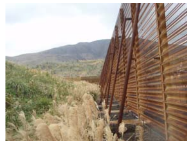
写真-1 防風柵腐食状況
